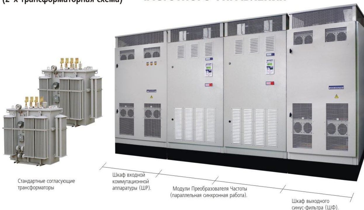
Рис. 2. Фото высоковольтного преобразователя частоты, установленного на НС-4 НФС-3.
