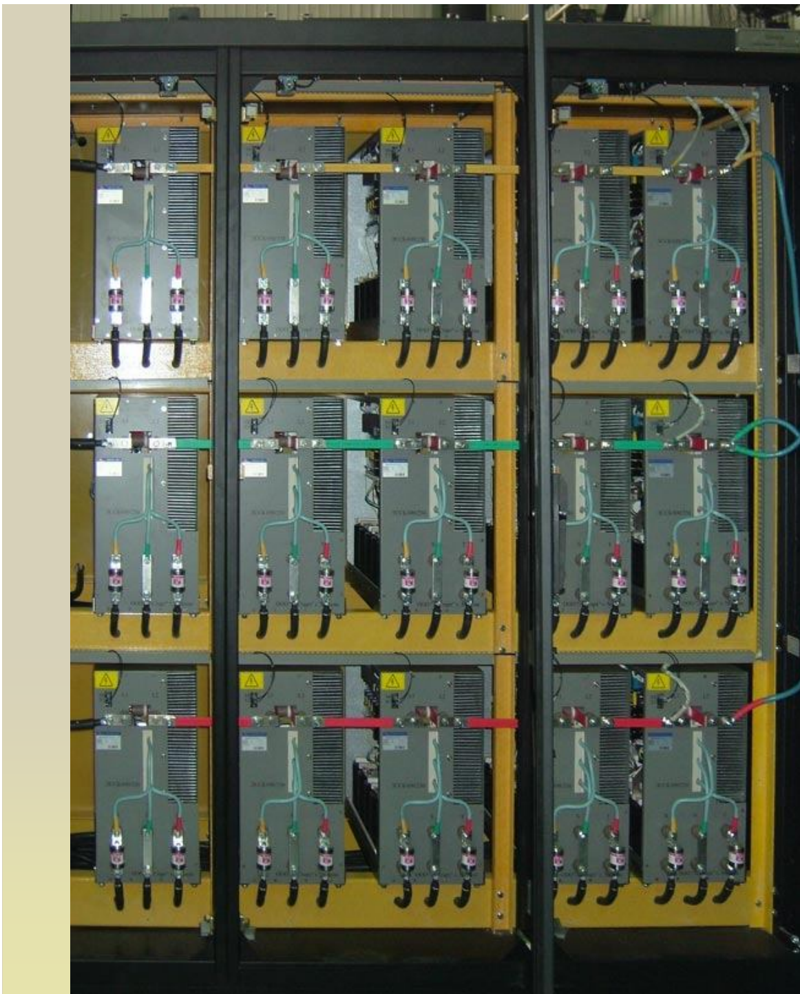
Шкаф силовых модулей (однофазных «Н-мостов»)
